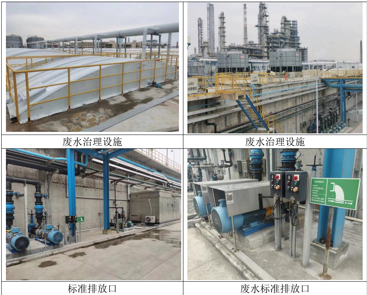
图 4-6 废水治理设施图片
