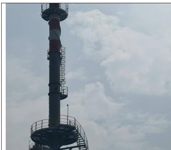
加氢进料加热炉废气治理设施（低氮燃烧器）
