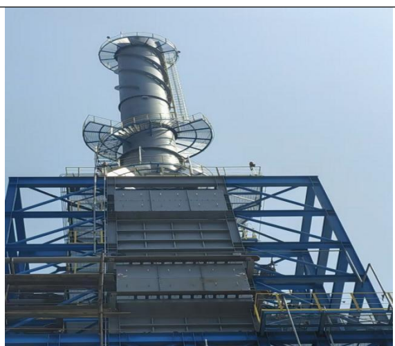
脱氢进料加热炉废气治理设施（低氮燃烧器）
