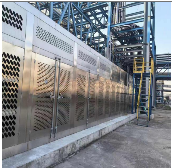
油气回收废气治理设施
